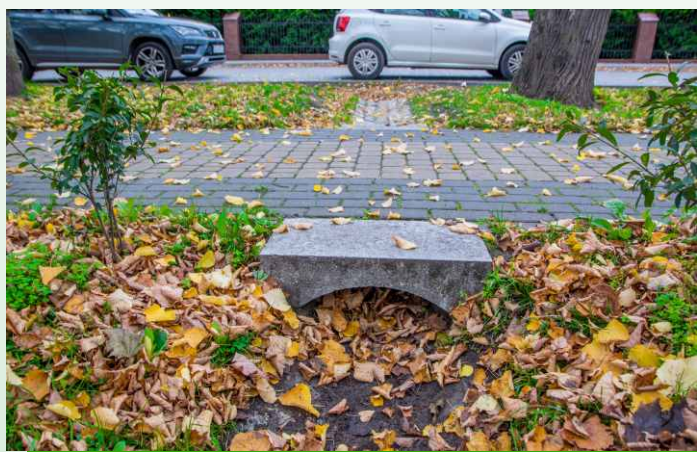
System odwodnienia przy ul. Filtrowej
